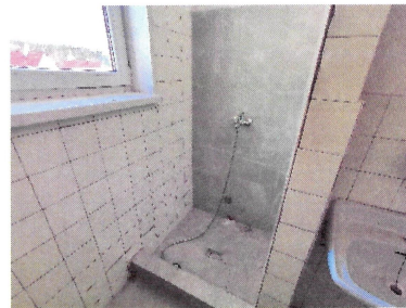
Kúpeľňa s WC (poškodený obklad a dlažba)
